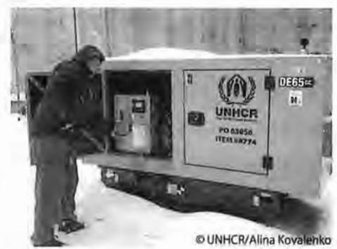
2022年11月、日本の支援でキーウ近郊に避難する人々のために設置された発電機
